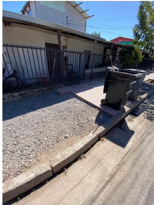
Fotografía N°6: Áreas de circulación de peatones sin los respectivos cierres de seguridad en contrato "Reposición de Veredas Población René Schneider".
