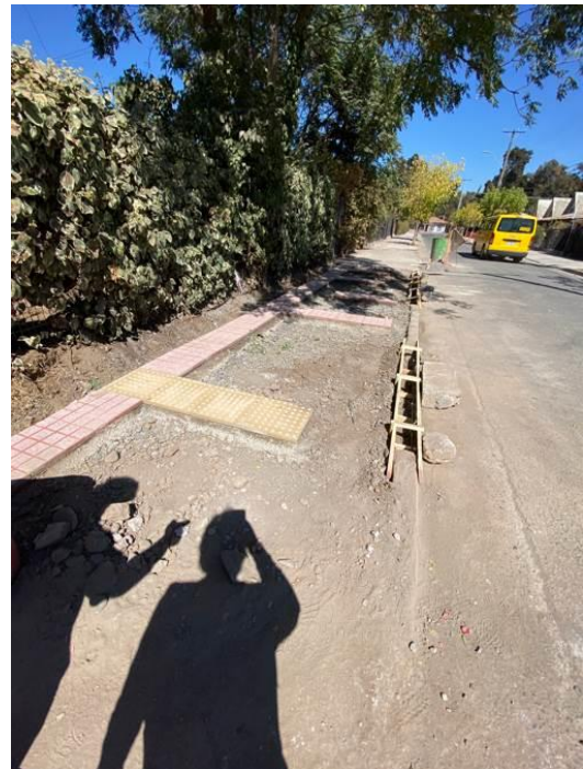
Fotografía N°4: Áreas de circulación de trabajadores sin los respectivos cierres de seguridad en contrato "Reposición de Veredas Población René Schneider".
