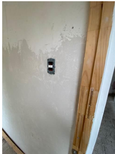
Fotografía N°20: Falta instalación de tapas en centros de alumbrado en contrato “Mejoramiento y Ampliación Posta de Salud Rural de Huemul y EMR Romeral Adentro”.
