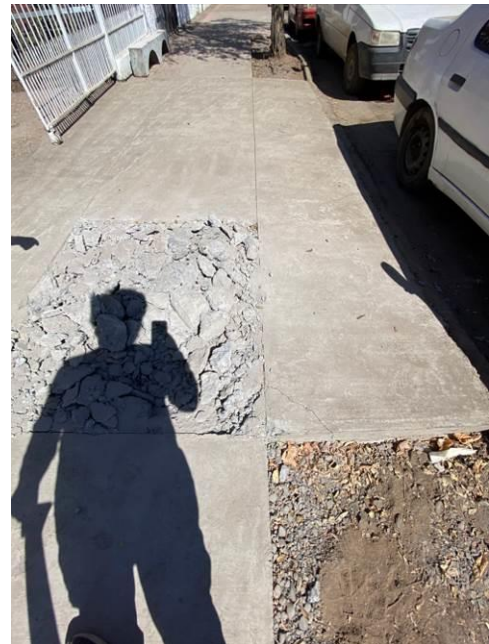
Fotografía N°24: Hormigón de vereda fisurado en contrato "Reposición de Veredas Población René Schneider".
