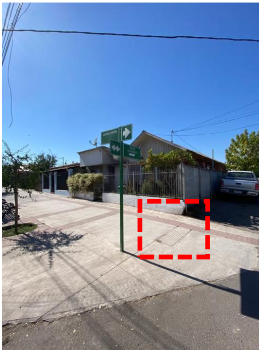
Fotografía N°11: Las rampas antideslizantes no son anteceditas completamente por un pavimento podotáctil en contrato "Reposición de veredas en Calle Javiera Carrera Hasta Rosendo Jaramillo".
