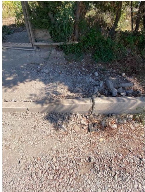
Fotografía N°18: Soleras sin mortero en las juntas en contrato “Mejoramiento Calle y Pasajes Villa Convento Viejo, Comuna de Chimbarongo”.
