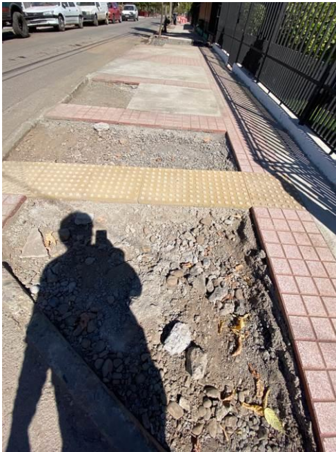
Fotografía N°5: Áreas de circulación de trabajadores sin los respectivos cierres de seguridad en contrato "Reposición de Veredas Población René Schneider".
