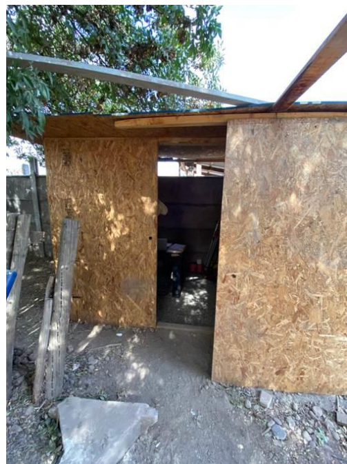
Fotografía N°8: No se encuentran extintores en los lugares de trabajo en proyecto "Reposición de Veredas Población René Schneider".
