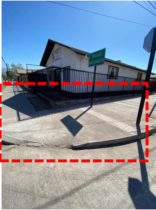
Fotografía N°9: Falta huella podotáctil del rodado en contrato "Reposición de Veredas Población René Schneider".
