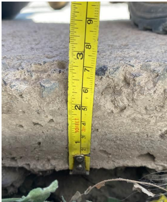
Fotografía N°17: Vereda en la entrada de vehículo con espesor menor a 10 cm en contrato “Mejoramiento Calle y Pasajes Villa Convento Viejo, Comuna de Chimbarongo”.
